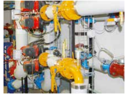
Réseaux de chaleur et d'énergie
